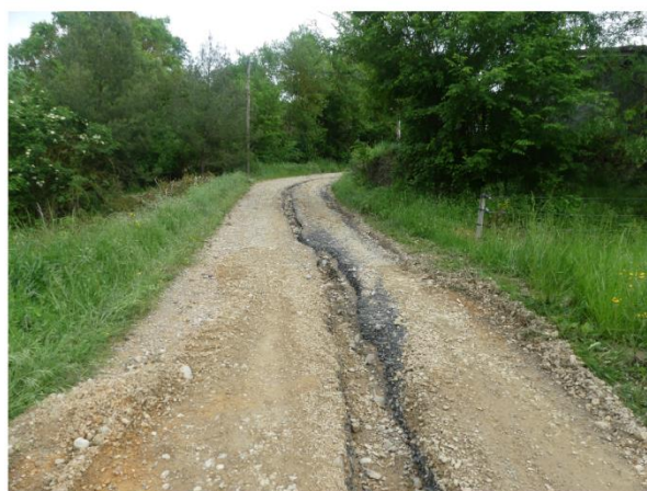
Ravinement sur chemin de terre «les Pujals» (Festes-et-Saint-André)
