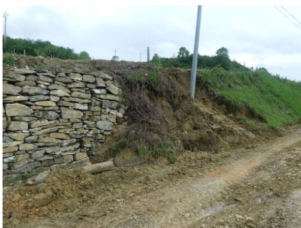
Eboulement de talus «les Pujals» (Festes-et-Saint-André)
