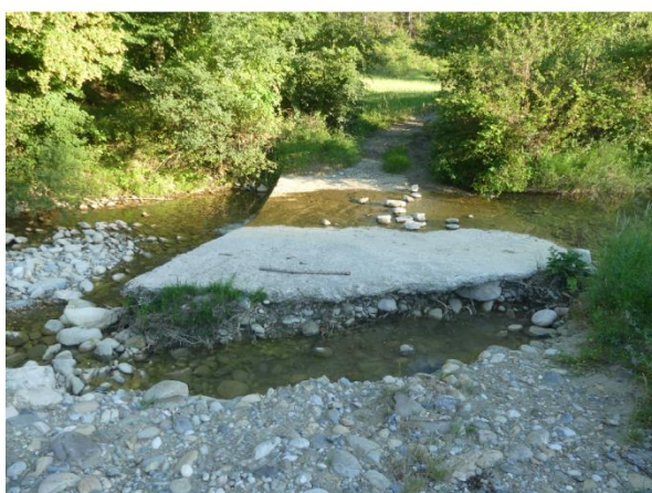
Gué sur la Corneilla détruit en partie par la crue du printemps 2018
