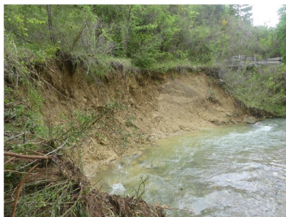
Forte érosion de berge sur la Corneilla
