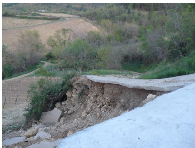
Erosion ayant emporté un bout de chemin (la Bouchère)
